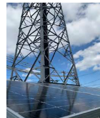
サステナブル基地局
